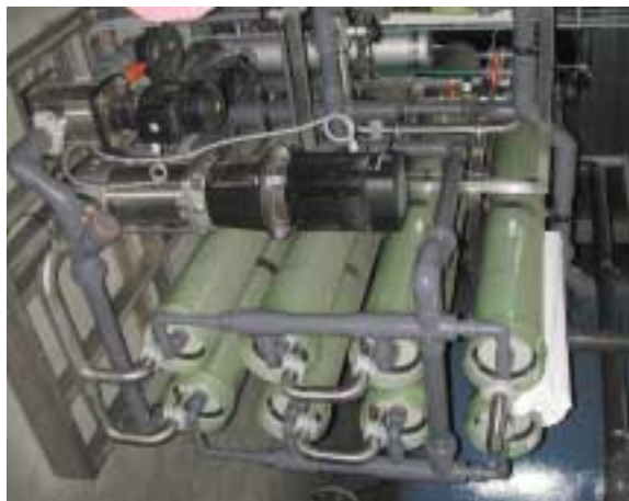
Impianto di desalinizzazione (osmosi inversa) in una serra olandese
