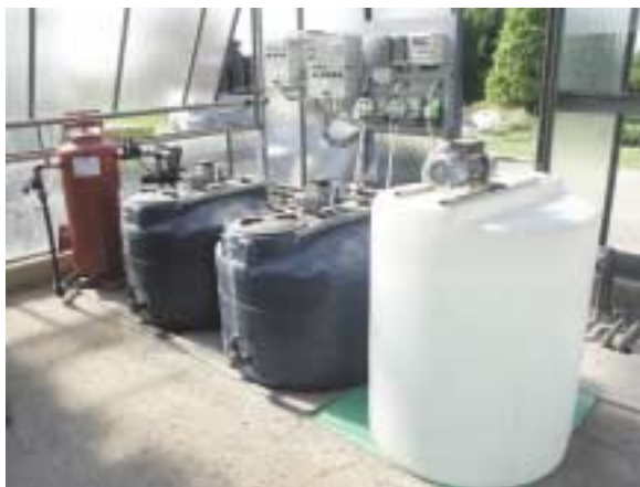
Impianto con pompe dosatrici a membrana con controllo di EC e pH, i due contenitori per le soluzioni stock, quello (bianco) per la soluzione acida (entrambi provvisti di agitatore ad asta), il filtro a sabbia autopulente (sul fondo) e la centralina di controllo con le tre pompe dosatrici
