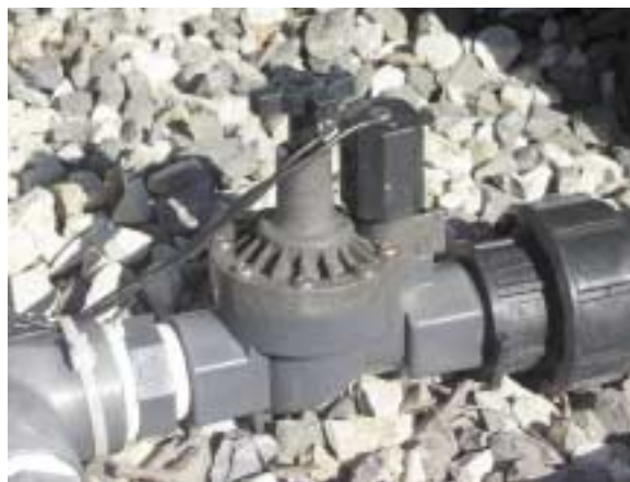
Elettrovalvola per il sezionamento dei settori irrigui. Questo modello di valvola ha una saracinesca per una preventiva riduzione della portata; ciò può essere utile per ottimizzare il funzionamento del fertirrigatore nel caso di coltivazioni con più settori irrigui di diversa superficie
